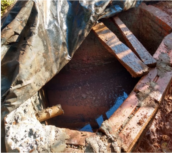
Estrutura precária da nascente
