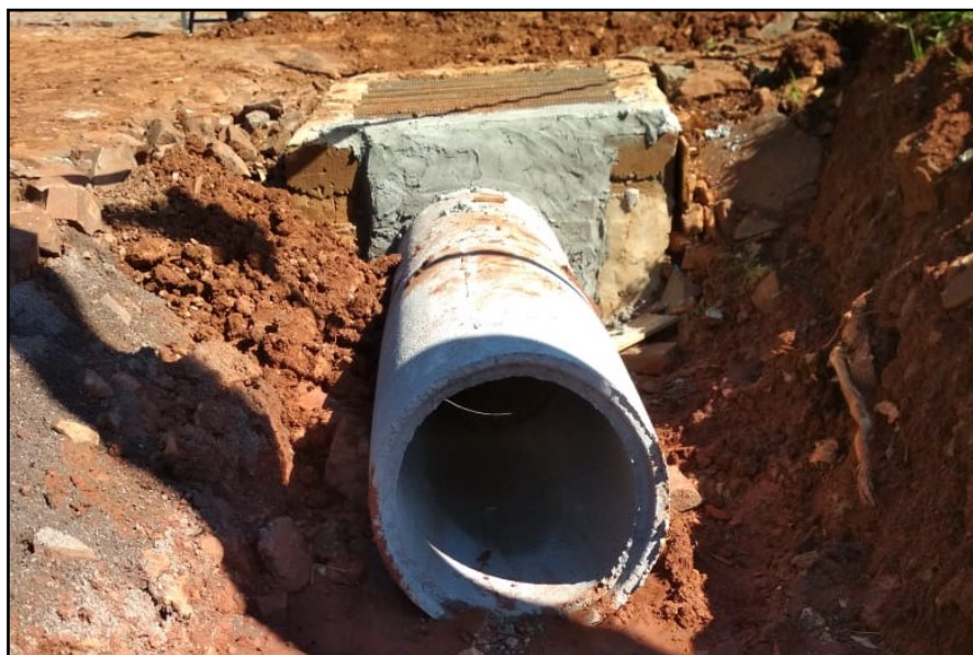
Figura 88 - Galeria localizada na área urbana de Tenente Portela.
