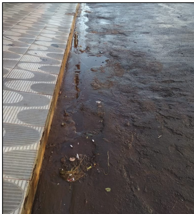
Figura 85 - Meio-fio localizado na área urbana de Tenente Portela.
