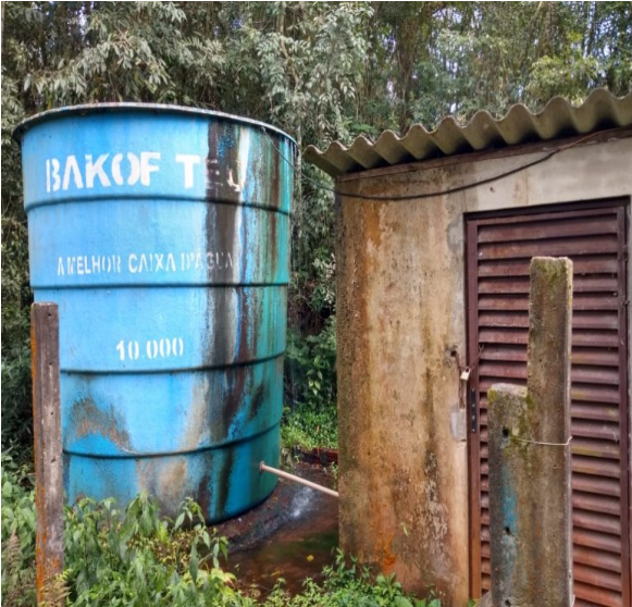
Reservatório e infraestrutura
