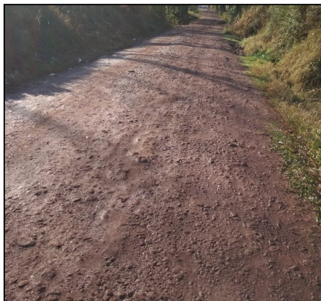
Figura 91 – Ausência de pavimentação em vias rurais.
