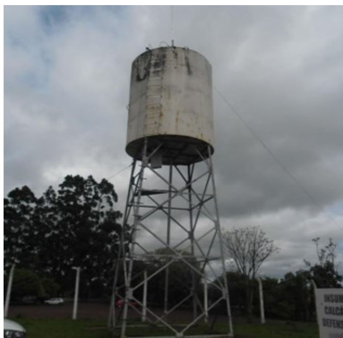
Figura 50 - Reservatório elevado com capacidade de 20 m 3
