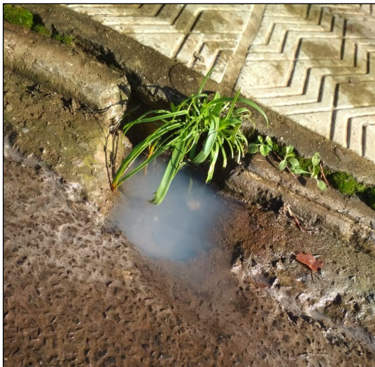
Figura 78 - Esgoto doméstico localizado na Rua Aracati.
