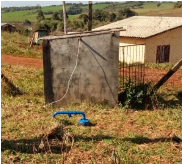
Poço e estrutura comprometida
