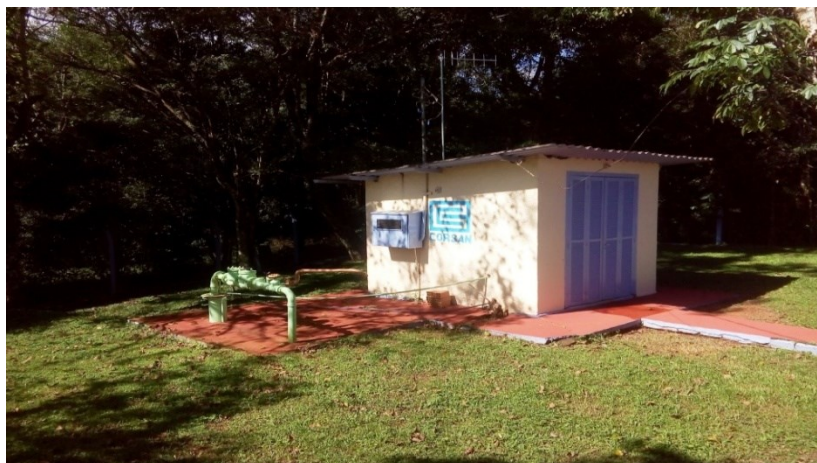
Figura 39 - Poço TPO-07 de captação para abastecimento urbano
