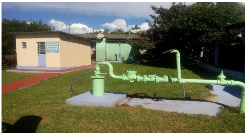
Figura 43 - Poço TPO-14 de captação para abastecimento urbano
