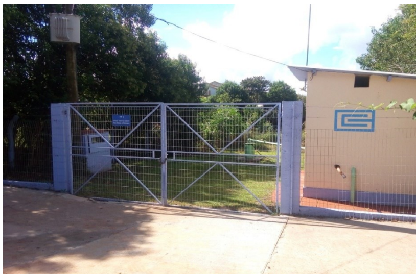
Figura 38 - Poço TPO-06 de captação para abastecimento urbano
