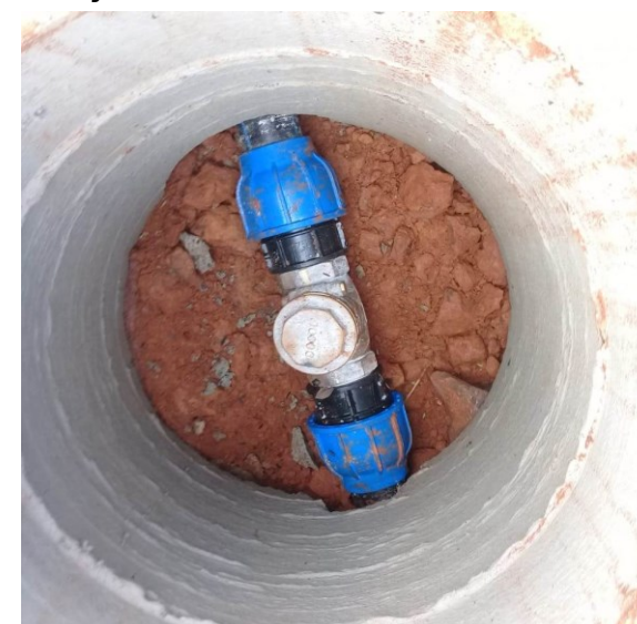
Conexão da rede
