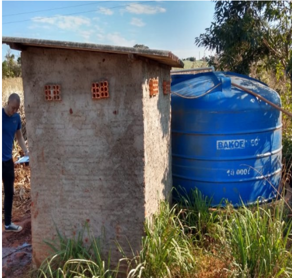
Reservatório e infraestrutura
