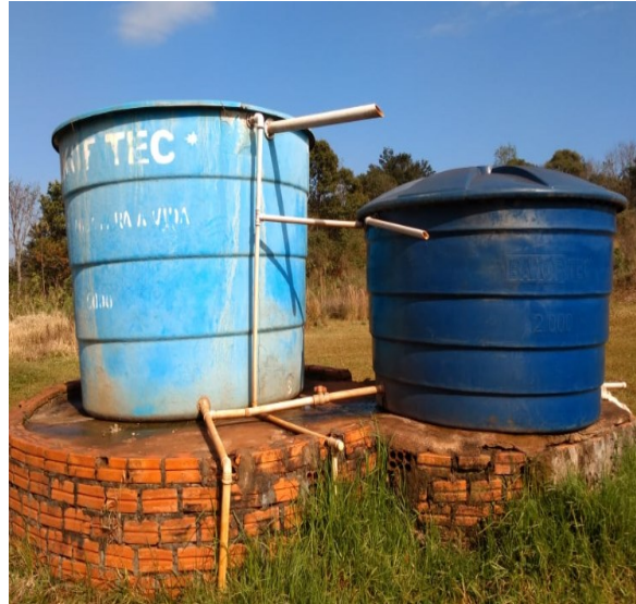
Reservatórios (R2 e R3)
