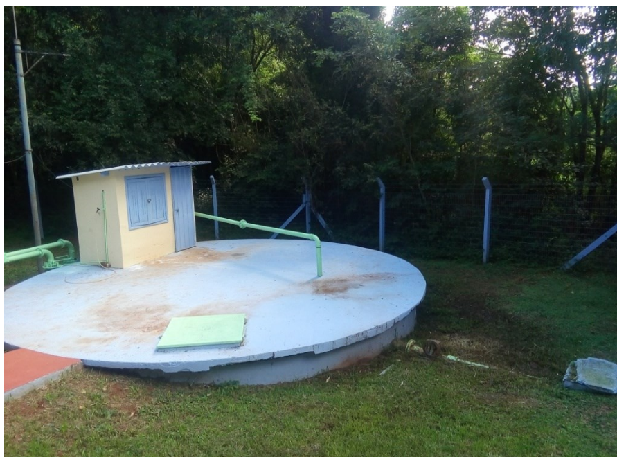
Figura 52 - Reservatório enterrado com capacidade de 100 m 3
