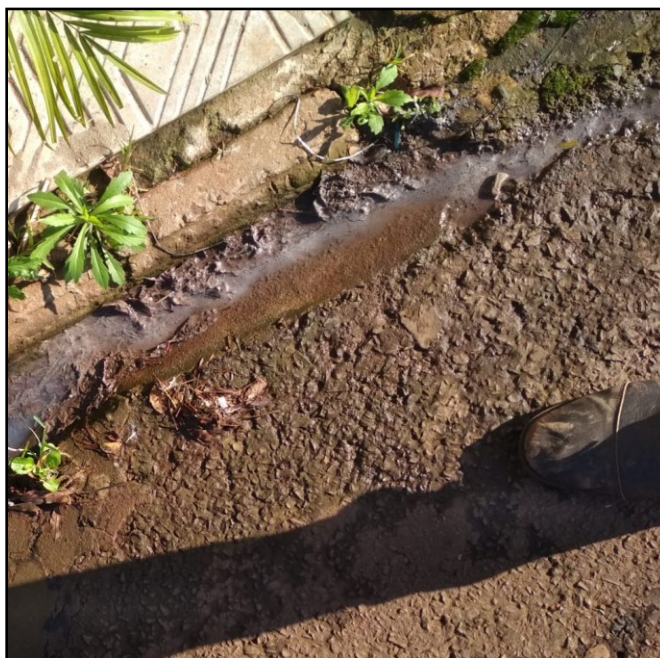
Figura 86 - Sarjeta localizada na área urbana de Tenente Portela.
