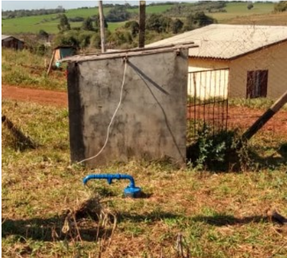
Poço e estrutura comprometida
