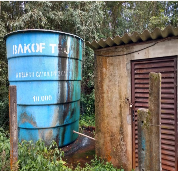
Reservatório e infraestrutura
