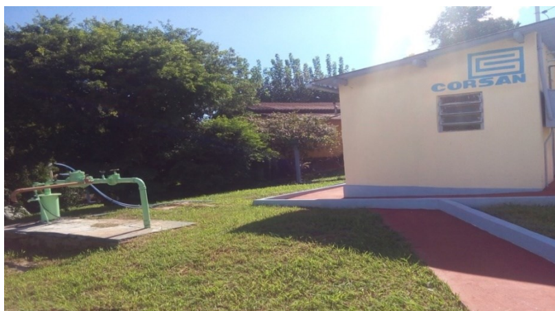
Figura 40 - Poço TPO-09 de captação para abastecimento urbano
