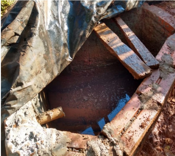
Estrutura precária da nascente
