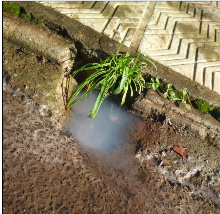
Figura 78 - Esgoto doméstico localizado na Rua Aracati.
