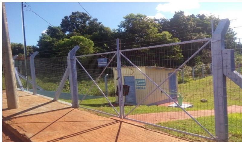
Figura 44 - Poço TPO-17 de captação para abastecimento urbano
