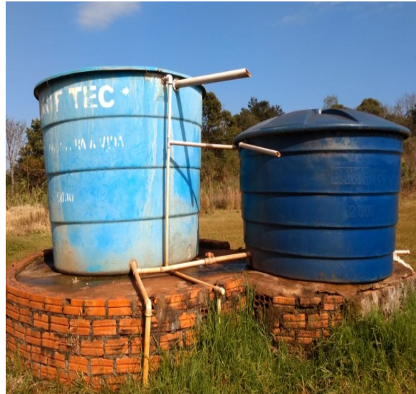
Reservatórios (R2 e R3)
