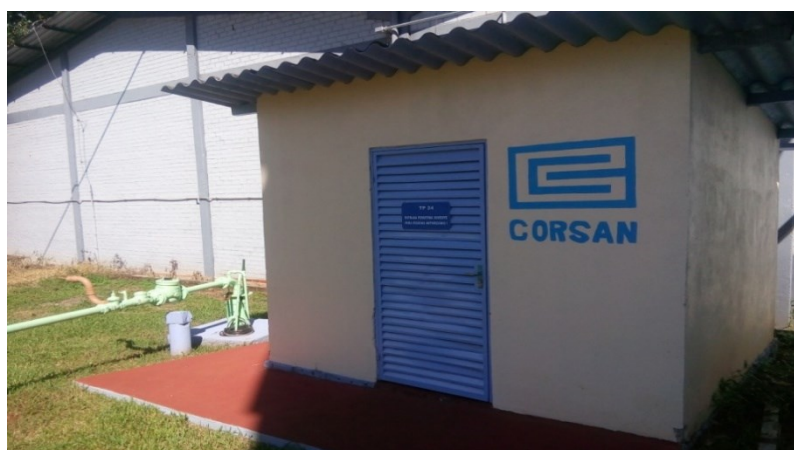
Figura 45 - Poço TPO-24 de captação para abastecimento urbano
