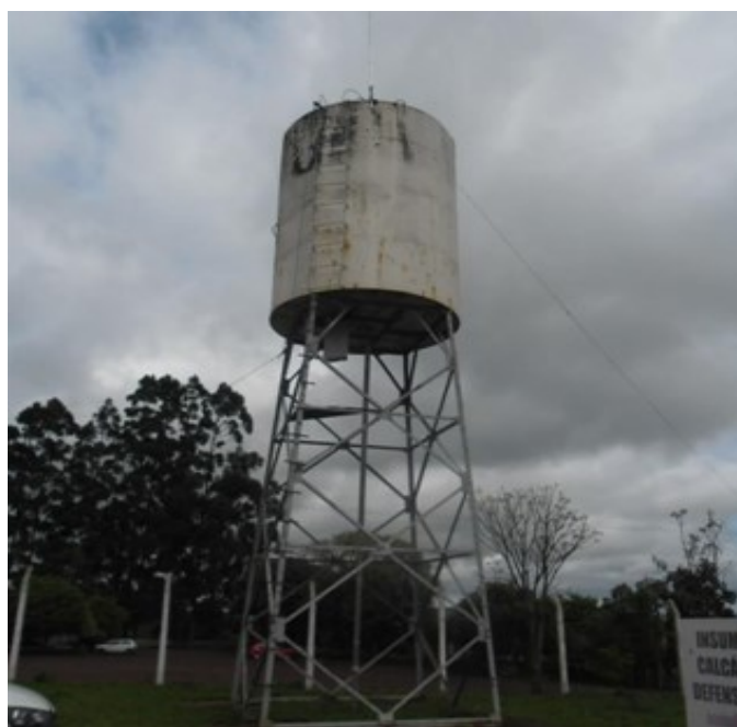
Figura 50 - Reservatório elevado com capacidade de 20 m 3
