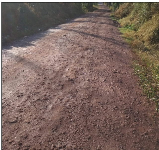
Figura 91 – Ausência de pavimentação em vias rurais.
