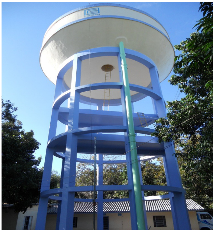
Figura 49 - Reservatório elevado com capacidade de 250 m 3
